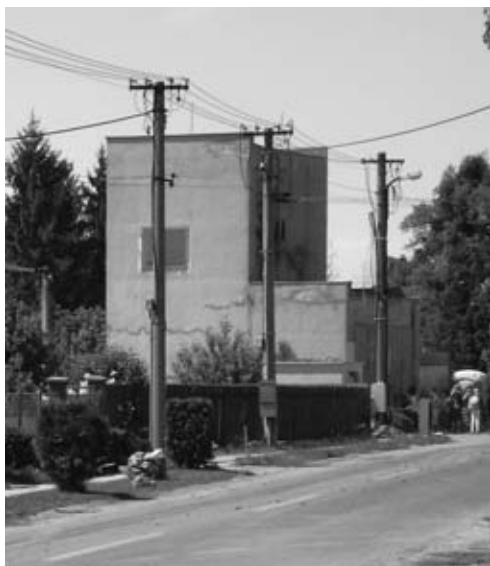
Budova trafostanice, ktorá bola postavená v 70-tych rokoch minulého storočia
